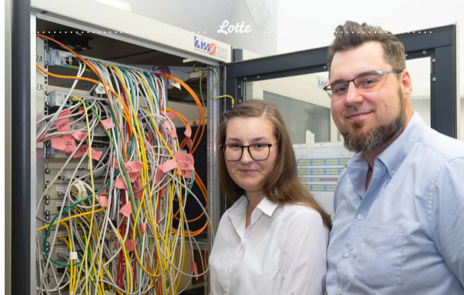
Keine Angst vor wirren Kabeln. Milena Zirpins hat den Durchblick im Serverraum – Toni Werda freut's.
