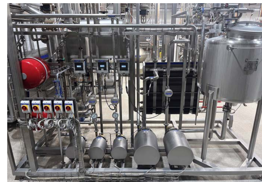
Eine fertig montierte Erhitzeranlage zur Milchverarbeitung
